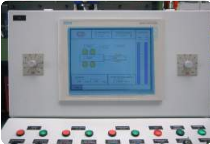
HMI Steuerung HMI Control
